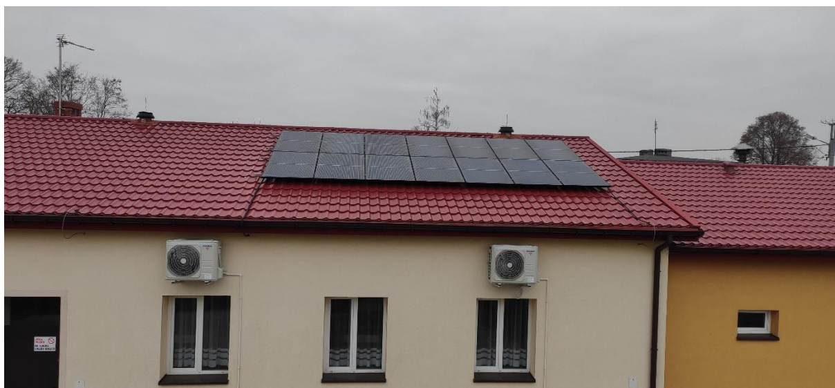
fot. Instalacja fotowoltaiczna w Cisewie
