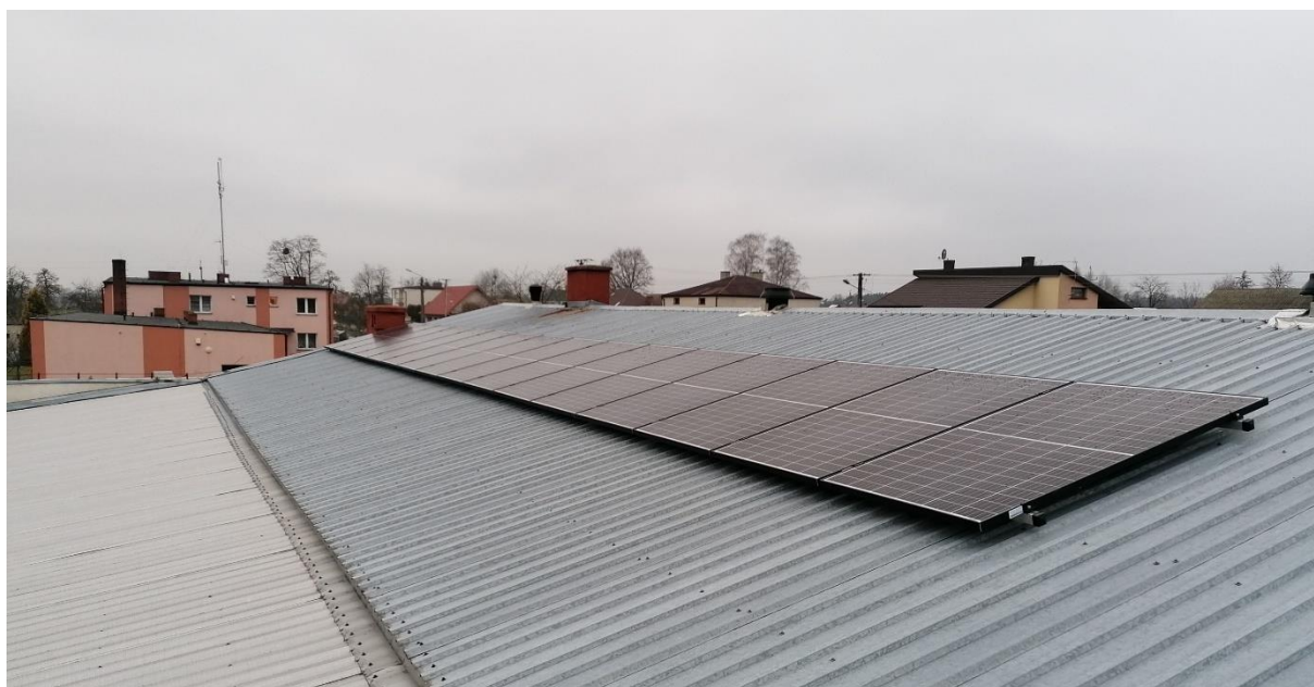
fot. Instalacja fotowoltaiczna w Kowalach Księżych
