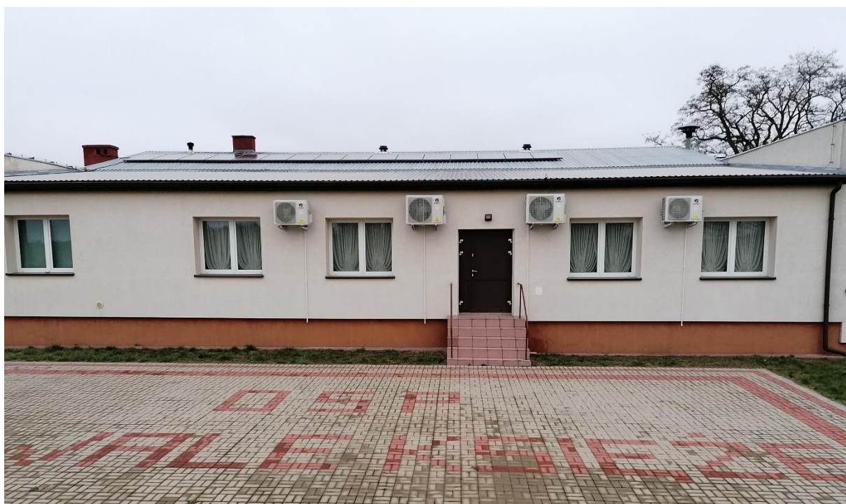
fot. Instalacja fotowoltaiczna w Kowalach Księżych
