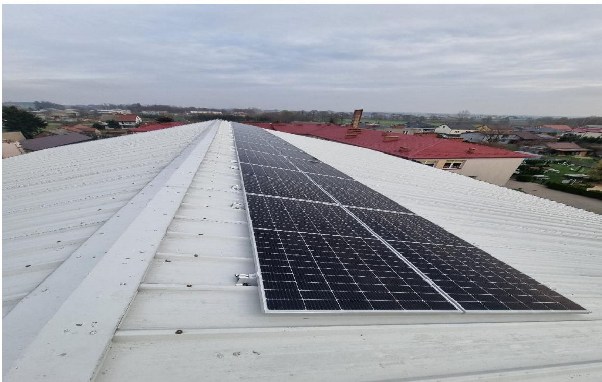
fot. Instalacja fotowoltaiczna w Zespole Szkolno – Przedszkolnym w Słodkowie
